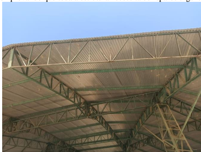
Foto 06 – Pontos de corrosão na treliça de borda, pilares treliças e demais elementos com alto índice de poeira.
