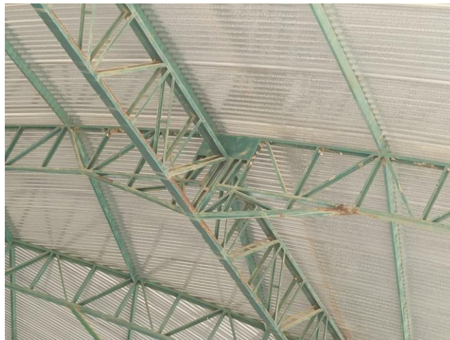
Foto 05 – Pontos de corrosão tanto no reforço entre treliça e arco, bem como na própria treliça, comprovando que toda a estrutura necessita de reparos urgentes.
