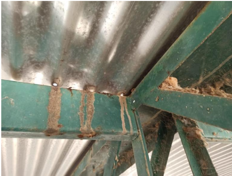
Foto 01 – Na imagem acima é possível identificar as telhas furadas sobre as terças, gerando acúmulo de corrosão, além da estrutura empoeirada e sem manutenção.
