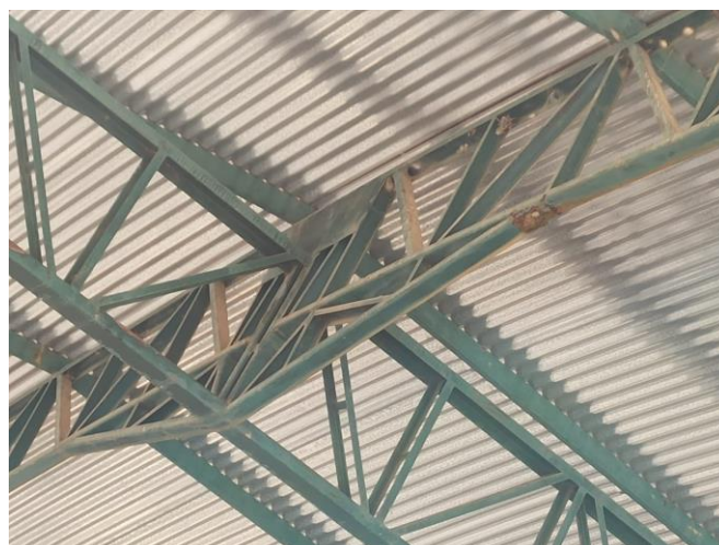
Foto 04 – Pontos de corrosão e estrutura empoeirada
