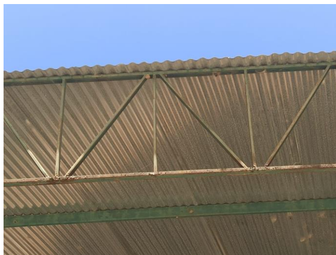
Foto 07 – Imagem aproximada elucidando Pontos de corrosão na treliça de borda.
