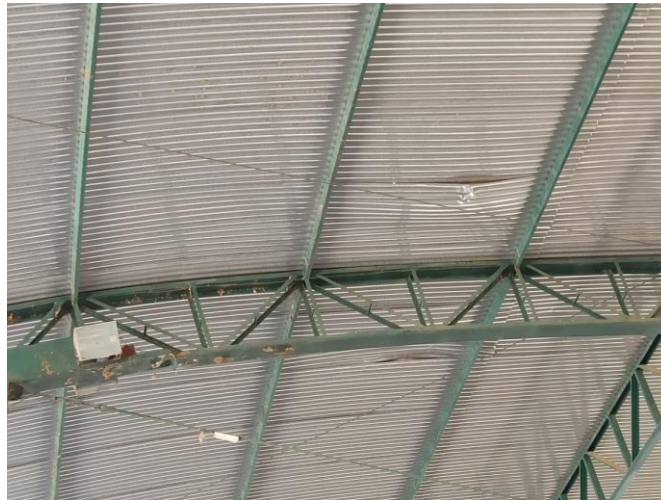
Foto 02 – Na imagem acima observa-se as telhas amassadas e pontos de vazamento a serem reparados.
