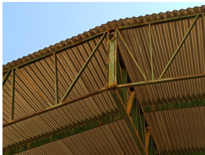
Foto 10 – Pontos de corrosão no encontro na treliça de borda e treliça do arco de fechamento da estrutura. Corrosão que já afetou os pontos de solda, ilustrando a necessidade urgente de manutenção.
