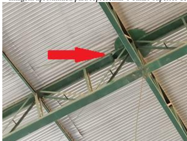
Foto 20 – Imagem feita em um novo ângulo para demonstrar o banzo superior deformado e em condições mais críticas do que as imagens do arco anterior.
