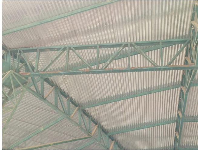
Foto 11 – Pontos de corrosão na treliça de sustentação executada sobre os pilares, além de representar acúmulo de poeira em toda a estrutura.
