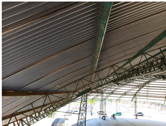
Foto 03 – Na imagem acima observa-se que a falta dos agulhamentos entre as telhas provocando o desalinhamento das peças.
