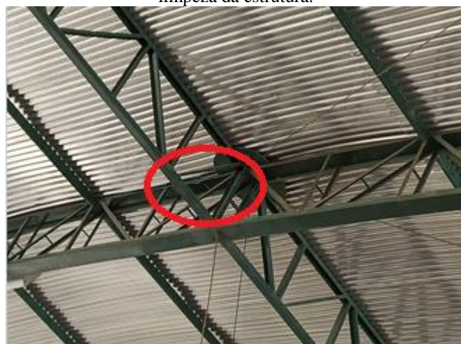
Foto 18 – Banzo superior deformado, ilustrando a necessidade de reforço do banzo inferior e superior desde o encontro entre arco e pilar até ultrapassar em no mínimo dois montantes do ponto deformado do banzo superior.
