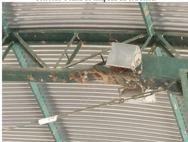
Foto 17 – Imagem aproximada representado banzo inferior deformado, frisando ainda sobre a falta de limpeza da estrutura.
