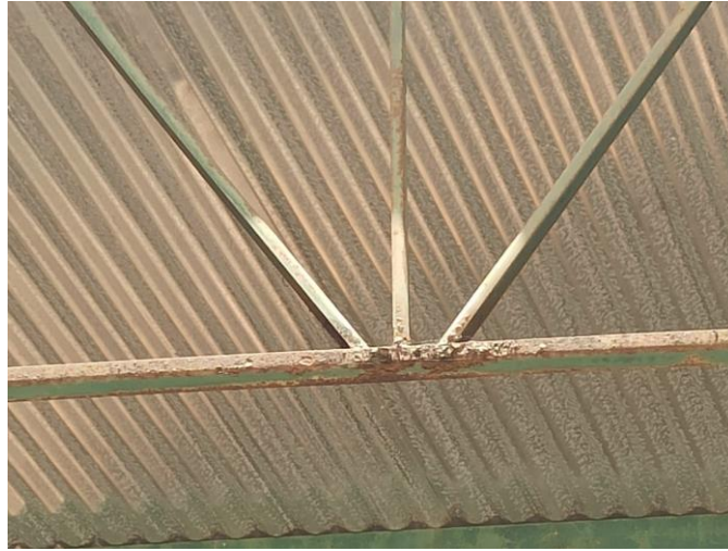
Foto 08 – Imagem aproximada elucidando Ponto de corrosão na treliça de borda.
