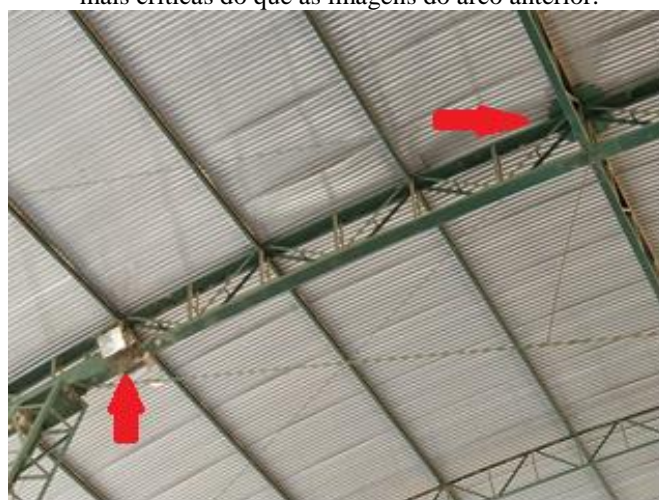
Foto 21 – Imagem com visão ampla para representar os pontos de deformação dos banzos inferior e superior do arco principal a serem reforçados.
