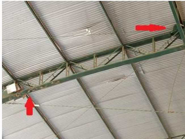
Foto 22 – Imagem aproximada representando os pontos de deformação dos banzos inferior e superior do arco principal a serem reforçados
