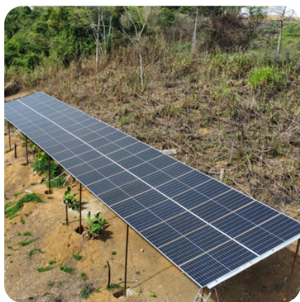
Projeto Residencial 24,84kWp - 46 Módulos Cariacica - ES
