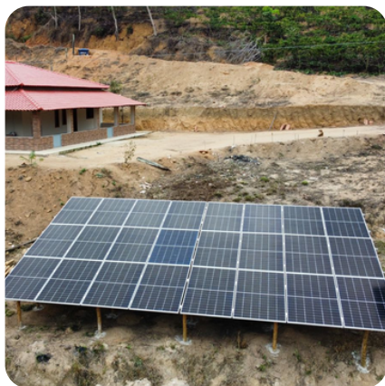
Projeto Rural 11,04kWp - 24 Módulos Barra de São Francisco - ES
