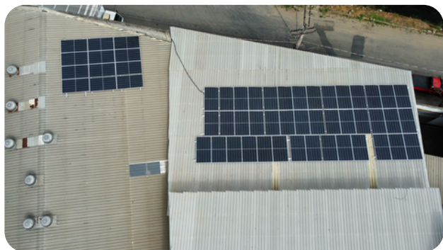
Projeto Industrial 27,00 kWp - 54 Módulos Cariacica - ES
