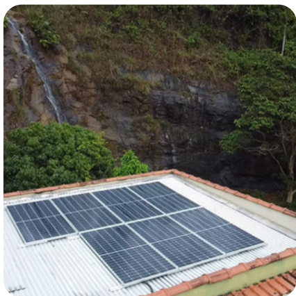
Projeto Residencial 3,15kWp - 07 Módulos Guaçuí - ES
