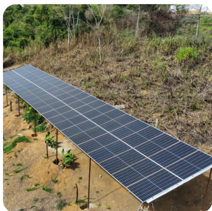
Projeto Residencial 24,84kWp - 46 Módulos Cariacica - ES
