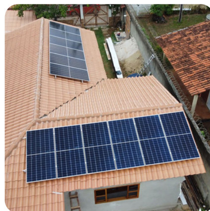
Projeto Residencial 6,48kWp - 12 Módulos Guarapari- ES
