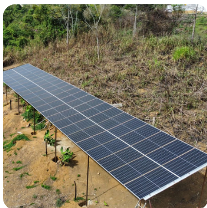
Projeto Residencial 24,84kWp - 46 Módulos Cariacica - ES
