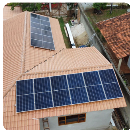
Projeto Residencial 6,48kWp - 12 Módulos Guarapari- ES
